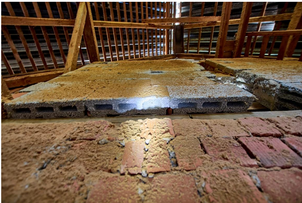
Abbildung 4 Lochsteine im Sägwerk unter denen am Boden Fledermauskot lag. (U. Scheurich)
